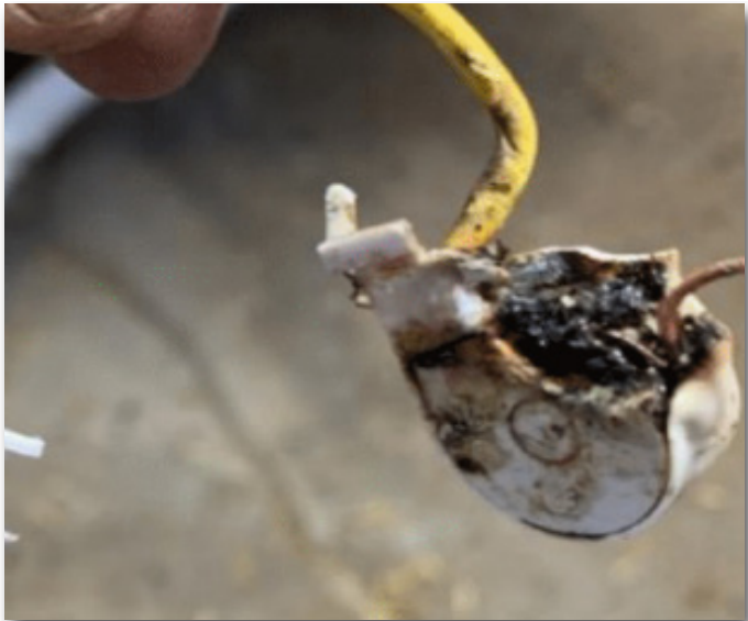
Connecteur de lumière endommagé.
