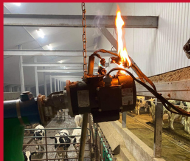
Détérioration d'un câble causée par la vibration d'un moteur.
