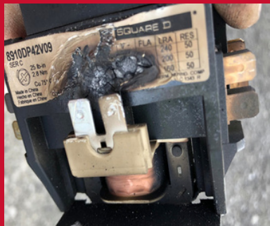
Défaut soudain sur un moteur de «mélangeur RTM».
